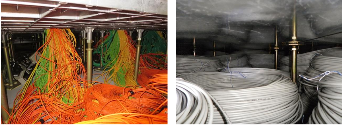
図 4-25 空流を阻害する床下配線の例
