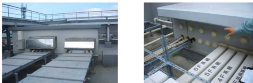
図 14 貫通部に直接雨水等が当たらないように対処した事例
