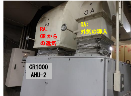
図 6-14 CR1000 の空調機 AHU-2
