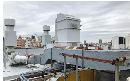
図 6-15 建物屋上での排気空気清浄装置 (スクラバー) 有り
