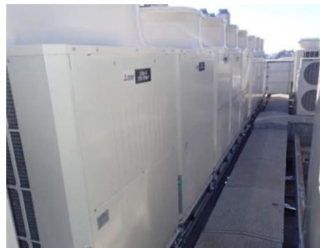
(b) 個別分散空調機の室外機(一例)
