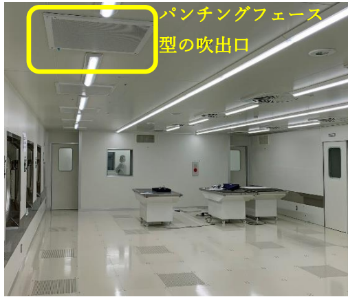
(a) 室内における設置状況
