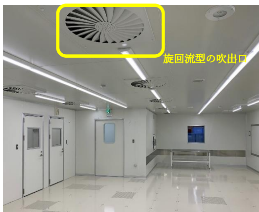
(a) 室内における設置状況
